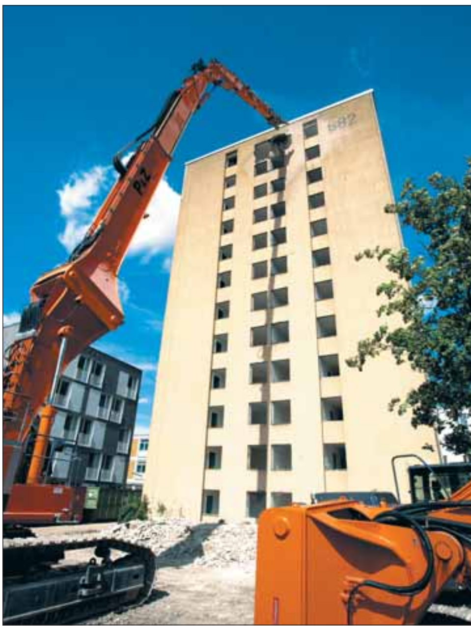
Ein Spezialbagger begann gestern das Hochhaus INF 682 abzureißen. Es muss vorsichtig gearbeitet werden, damit die neuen Wohnheime (links) nicht beschädigt werden. Foto: Kresin
